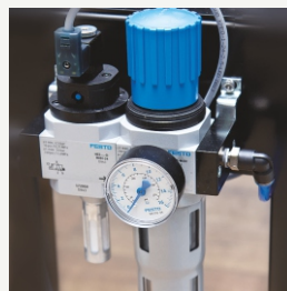
Stacja przygotowania powietrza
