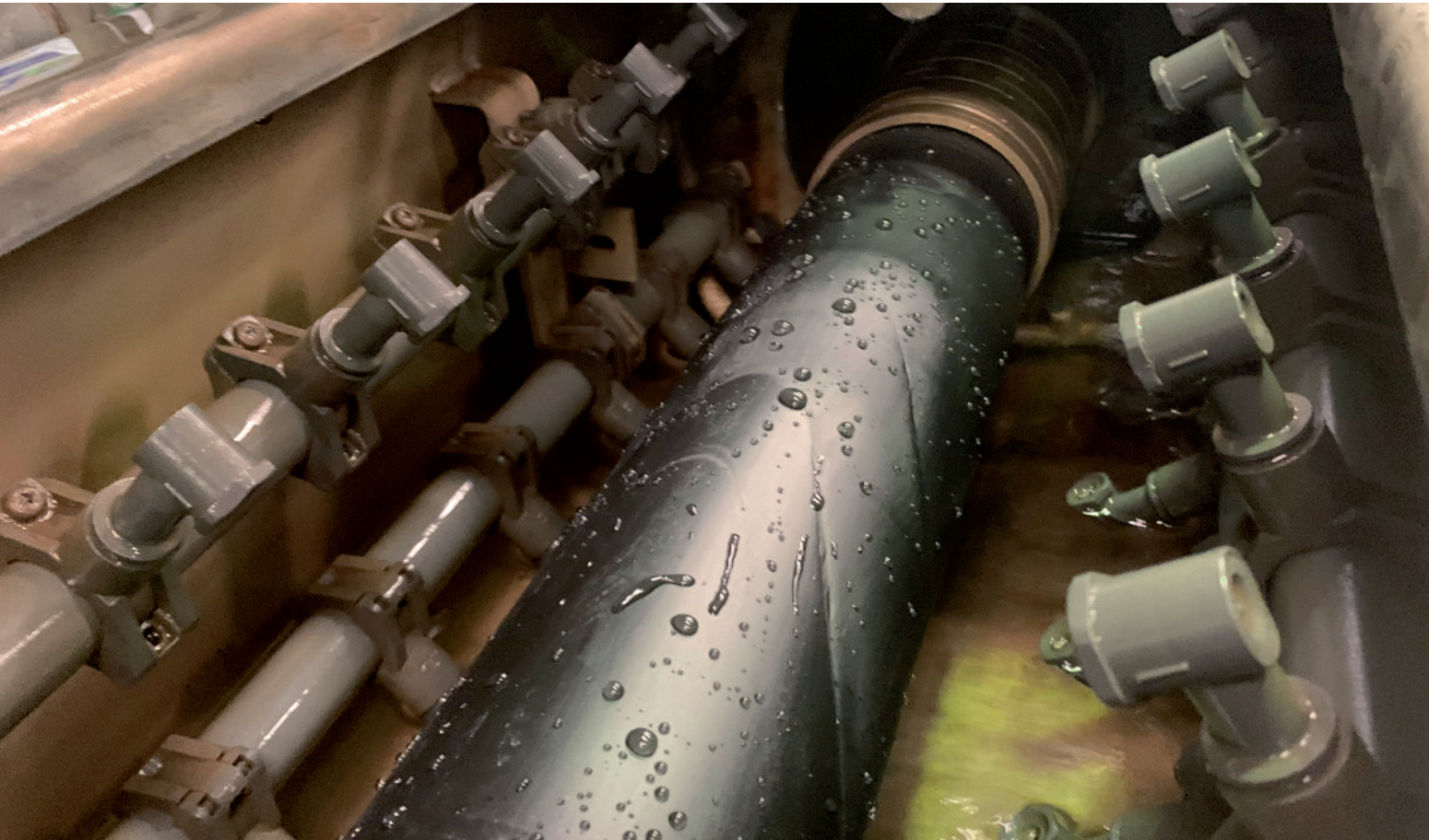
Proces wytłaczania rur PE-HD – jednostka chłodząca z systemem natrysku wody z chillera
